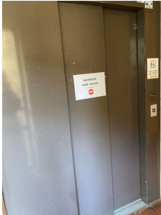
Légende : Vue de l'ascenseur au rez-de-chaussée du musée.
